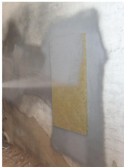
Pegado de lana de roca a paramento y formación de membrana acústica in situ.
